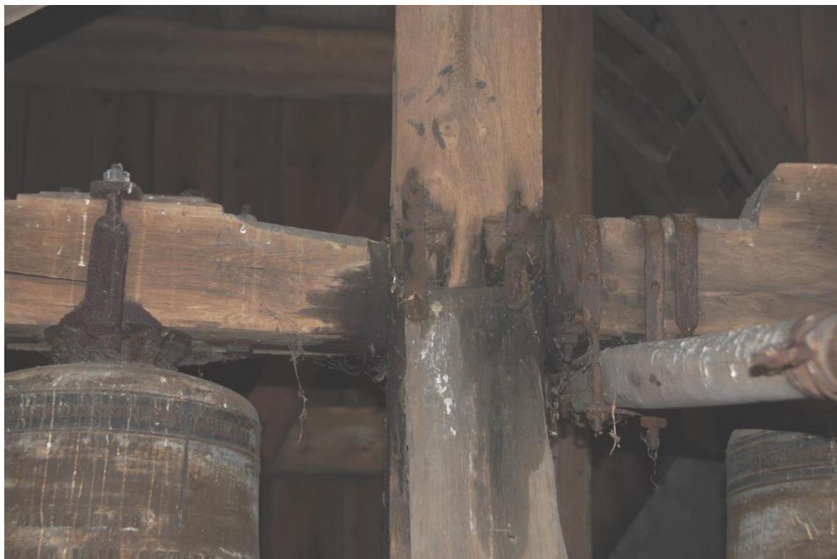
fot. Zawilgocona dzwonnica
