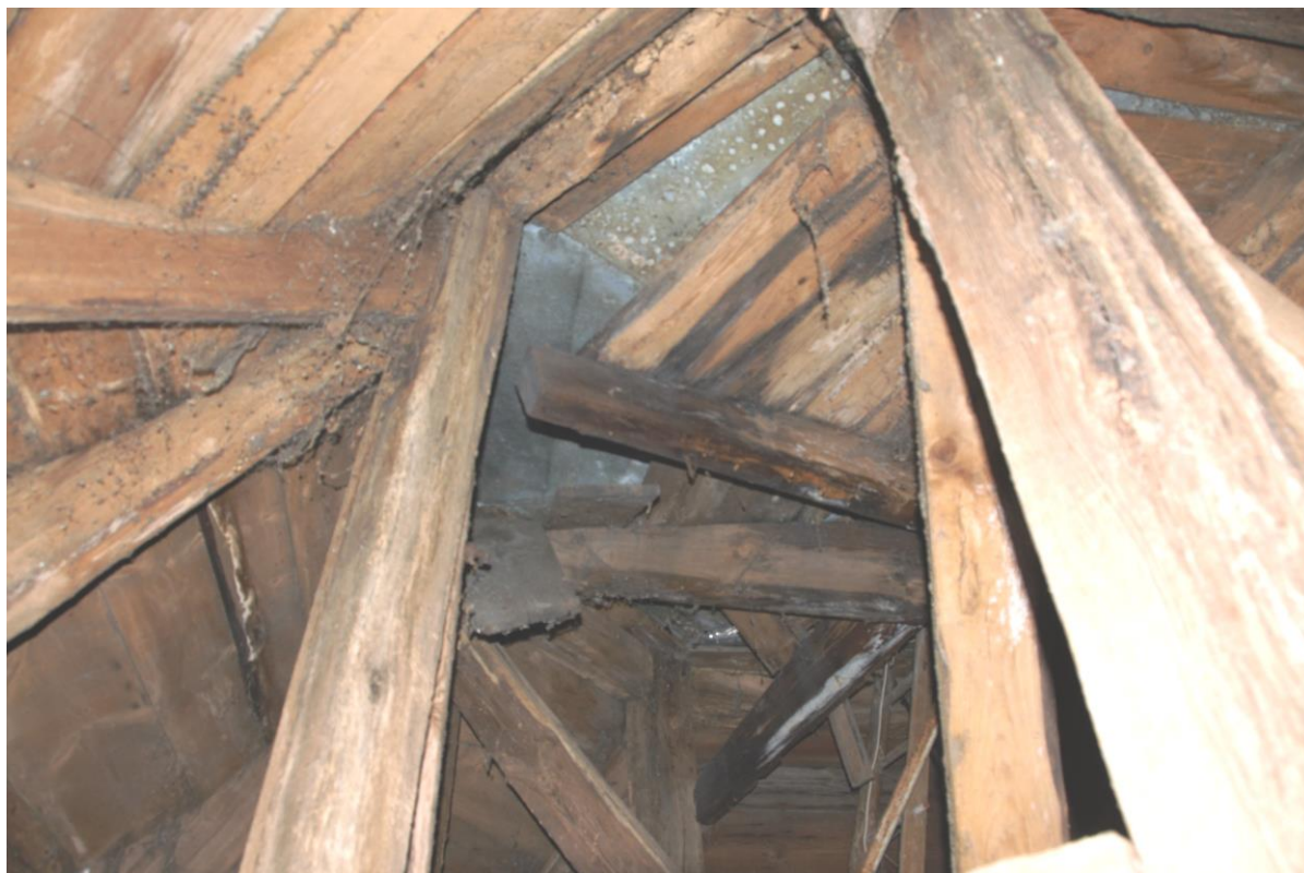
Fot. Strop nad poziomem hełmu z zarwanym stropem
