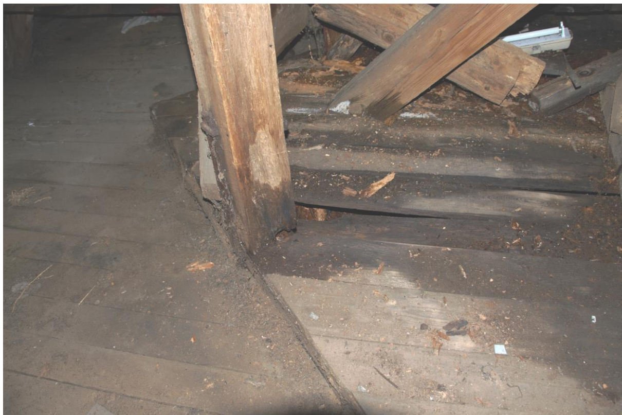
Fot. Podłoga poziomu helmu - zawilgocenia
