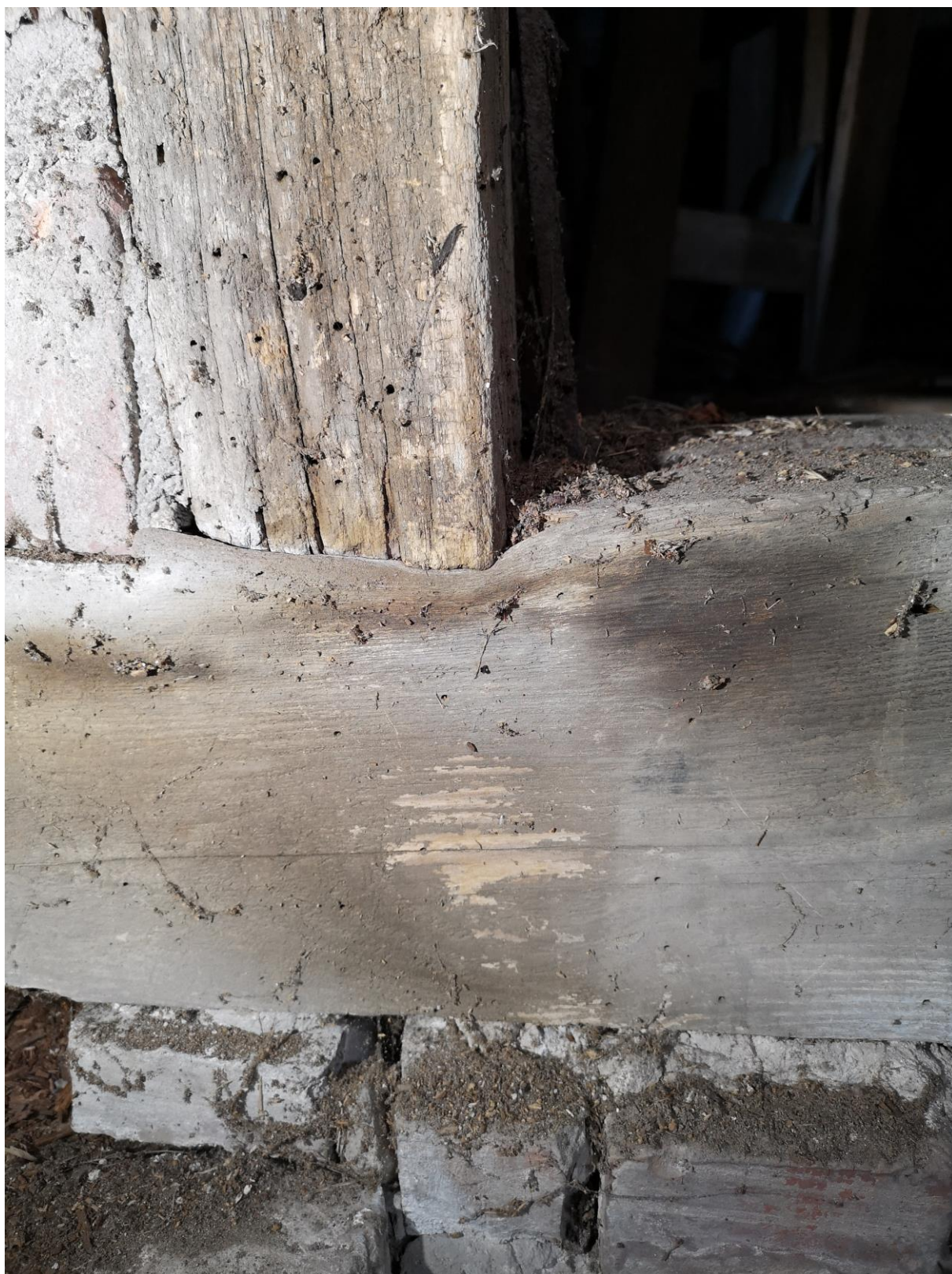
fot. Słup miążdzący podwalinę – widoczna zmiana przebiegu włókien drewna na styku słupa z podwaliną
