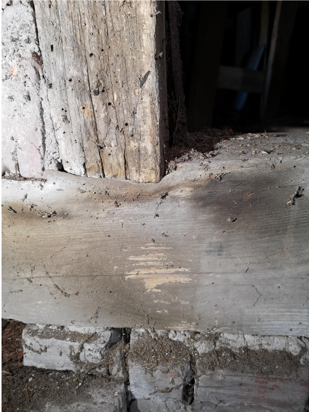
fot. Słup miążdzący podwalinę – widoczna zmiana przebiegu włókien drewna na styku słupa z podwaliną
