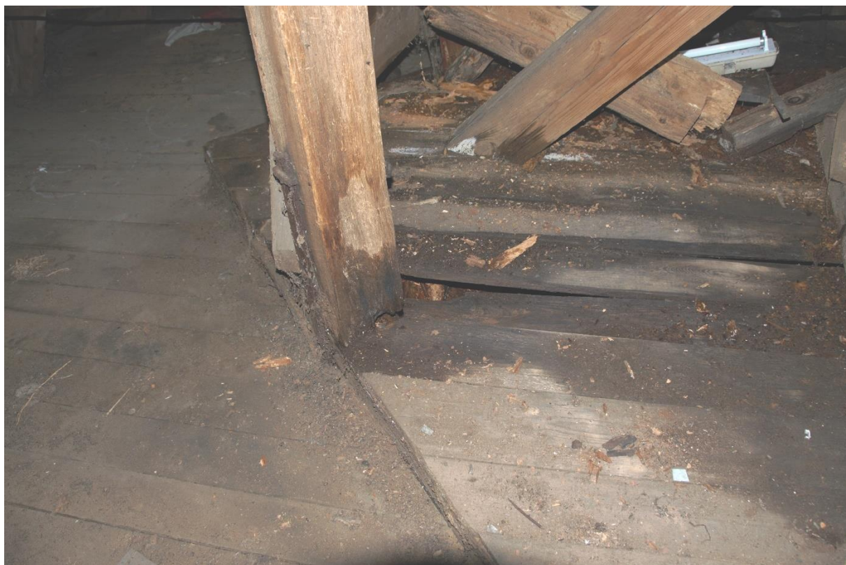
Fot. Podłoga poziomego hełmu - zawilgocenia
